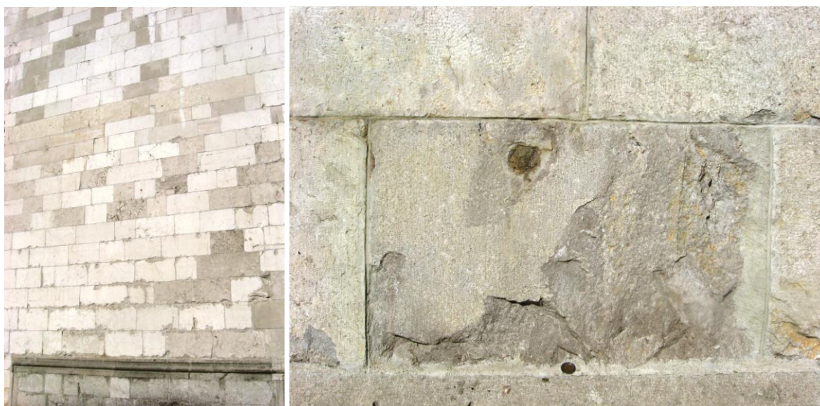
Figura 22. Particolari della facciata del Duomo di Cividale del Friuli (UD) realizzato in pietra piacentina (unità U_4 ). A destra, una pietra rovinata consente di riconoscere le caratteristiche del litotipo di norma mascherate dalle texture .
