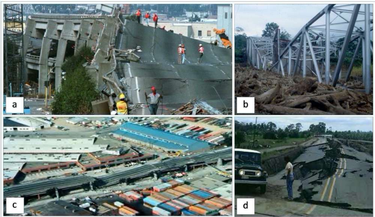
Fig. 1.18) a) Esempio di collasso di più campate di un ponte nella zona di Santa Cruz-terremoto Loma Prieta (USA) di Mw=7.1 “Immagine digitale” (fonte: BPH-MIK (ottobre 17, 2017) blueplanetheart: “ 17 ottobre 1989: la California colpita dal terremoto di Mw 6.9 di Loma Prieta” http://www.blueplanetheart.it/2017/10/17-ottobre-1989-la-california-colpita-dal-terremoto-mw-6-9-loma-prieta/ Data di consultazione 25 luglio 2022); b) Esempio di crollo del ponte sul fiume La Estrella, a Limón-terremoto Costa Rica di Mw=7.5 (fonte: M.A. Sayed, et al. (2019); c) Esempio di danneggiamento di un viadotto-terremoto Loma Prieta (USA) di Mw=7.1 “Immagine digitale”(fonte: https://it.wikipedia.org/wiki/Terremoto_di_Loma_Prieta_del_1989 Data di consultazione 25 luglio 2022); d) Esempio di danneggiamento di una strada dove la pavimentazione fu attraversa da ampie fessure- terremoto Costa Rica di Mw=7.5 (fonte: Sayed, et al. (2019)).
