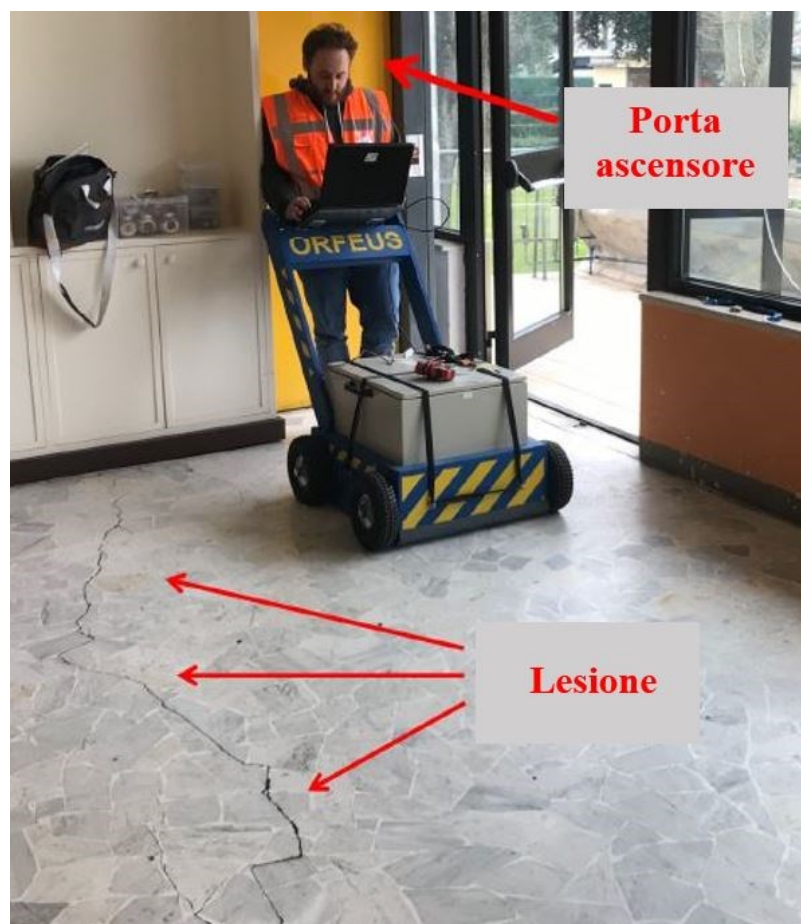
Fig. 68. Vista di dettaglio della lesione al primo piano e della strumentazione radar "ORFEUS" utilizzata
