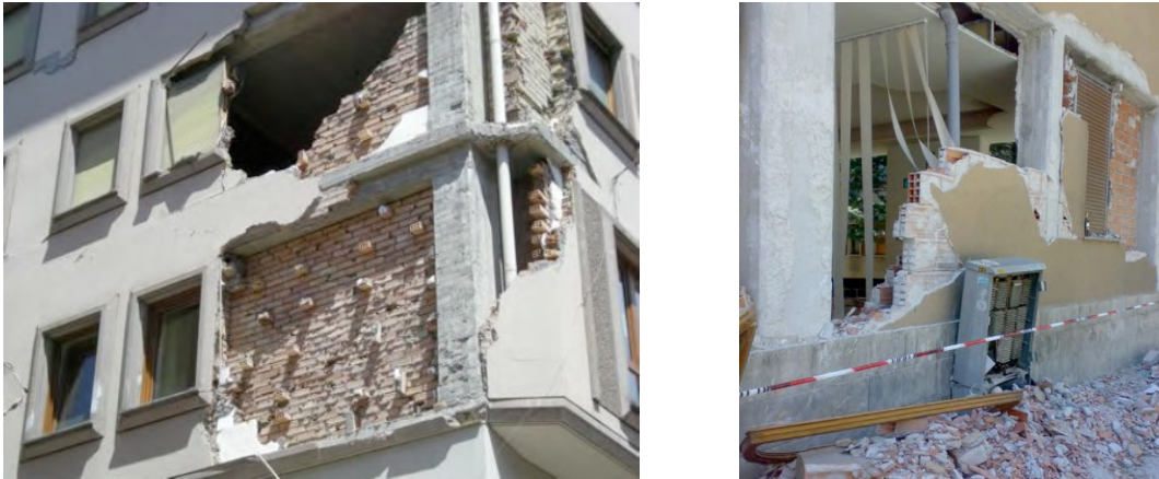
Figure 22 Infill damages after L'Aquila (IT) earthquake in 2009 (Dipartimento della Protezione Civile, 2009)
