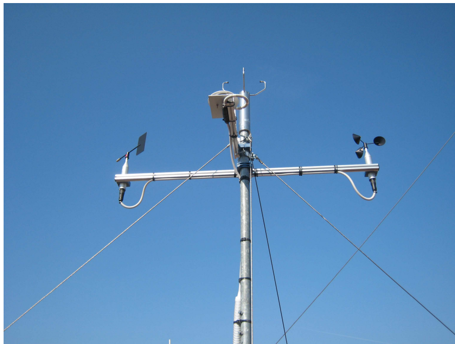
Fig. 3.- Posizione del piranometro dal 23 febbraio 2012.
