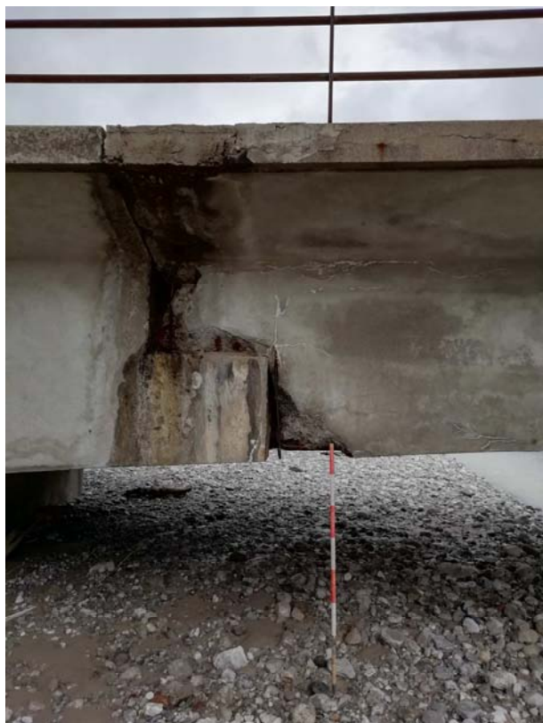
Fig. 10.1 Fenomeni di danneggiamento localizzato del ponte sulla SR552 in località Caprizi. Si noti la rottura del copriferro ed il processo di ossidazione in atto dell'armatura in coincidenza dell'appoggio tra campata e pila. Si noti inoltre la ridotta luce disponibile al di sotto dell'impalcato (130 cm circa).
