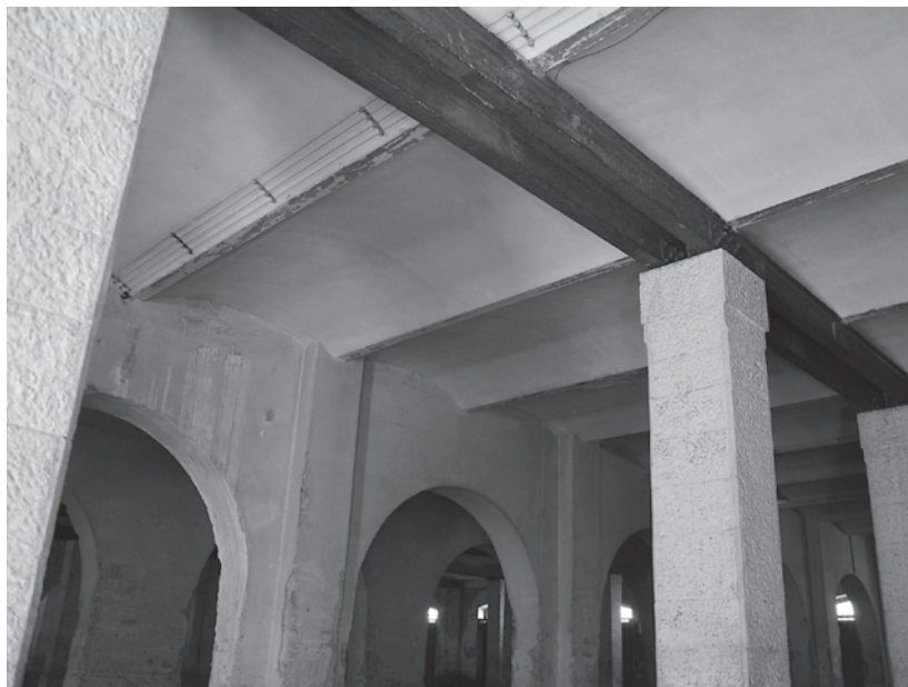
Figura 13 – Primo solaio dell’Hangar n. 9: sono ben visibili le voltine in cemento armato incastrate in travi in ghisa con profilo a doppio T rivestite in calcestruzzo.
