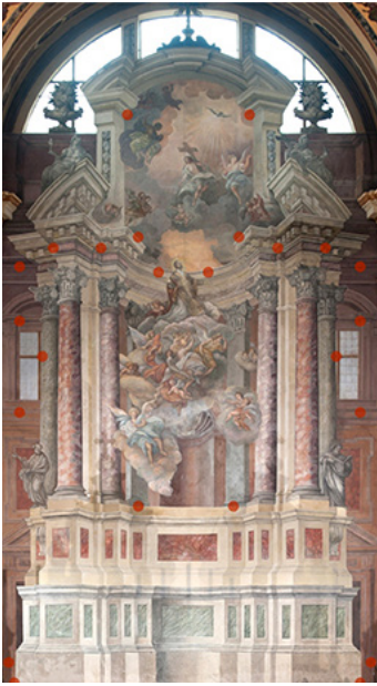
Fig. 208 - Difformità rilevate tra le parti destra e sinistra dell'affresco.
