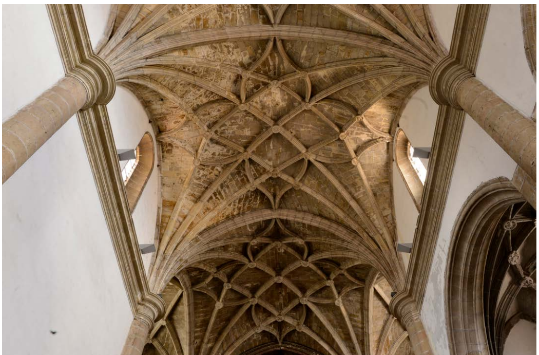
Fig. 1. Immagine del sistema voltato della navata della chiesa di San Miguel, rendering della nuvola di punti della campata analizzata (elaborazione grafica A. Bortot).
